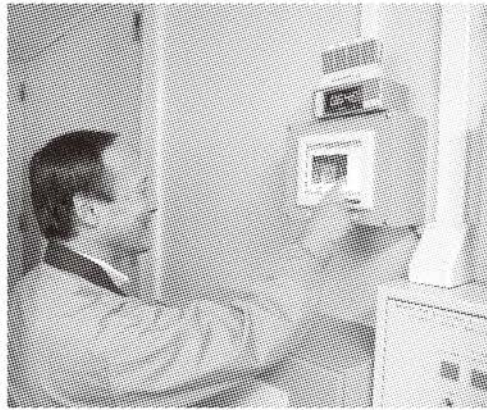
タッチパネルによるヒートポンプ設備操作は、瞬時に切り替えが可能
